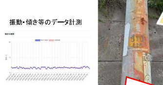
実験結果を検証（腐食状況とデータの相関性等）
