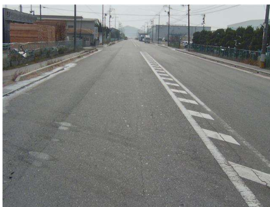
路面の損傷（ひびわれ）
