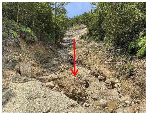
土砂流出状況
