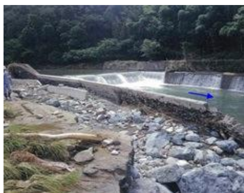
護岸背面の流出
