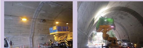
【トンネル補修】 国道184号 木門田トンネル (尾道市木ノ庄町) 【R2 完了】
