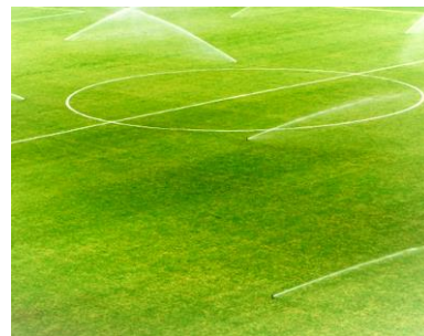
芝の散水設備
