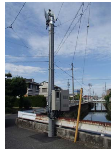
河川監視カメラ設置状況
