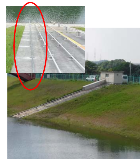
春日池水位計設置状況
