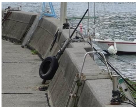
護岸に打ち付けられた梯子
