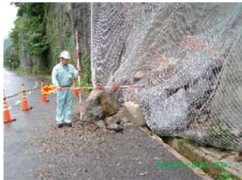
H20.8.28落石状況
