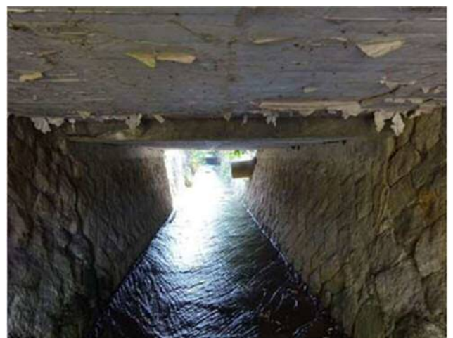
上流側劣化状況
