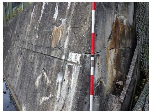
擁壁のクラック
