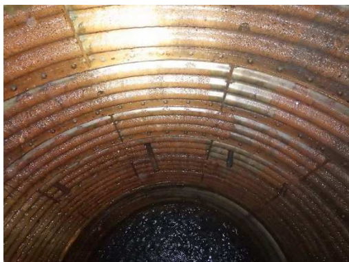
集水井鋼材の腐食
