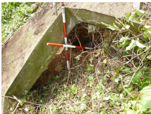
法枠工背面土砂の流出
