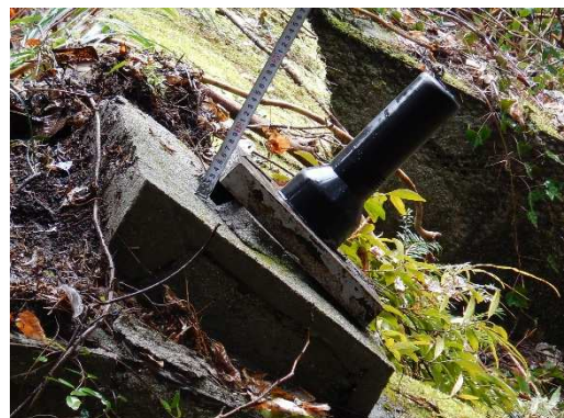
アンカー頭部の浮き
