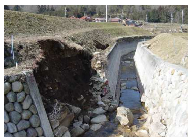
護岸工の損傷
