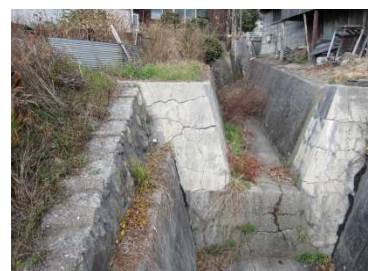
床固工のひび割れ
