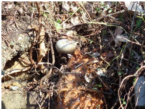
横ボーリングエの目詰まり
