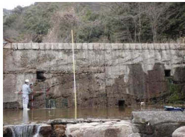
劣化・剥離・漏水
