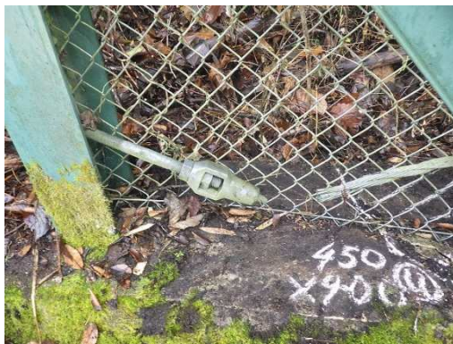
落石防護柵の破損
