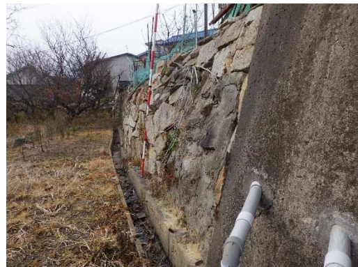
土留エの押し変状
