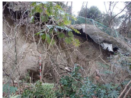
モルタル吹付の剥落
