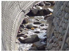
護岸工基礎部の洗掘
