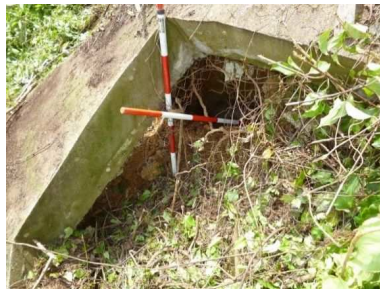
法枠工背面土砂の流出
