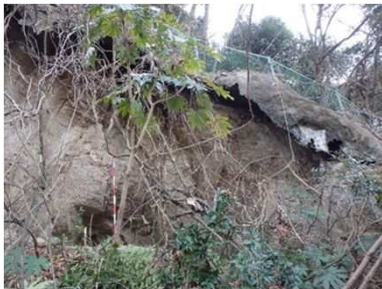
モルタル吹付の剥落
