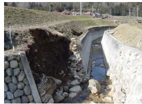
護岸工の損傷
