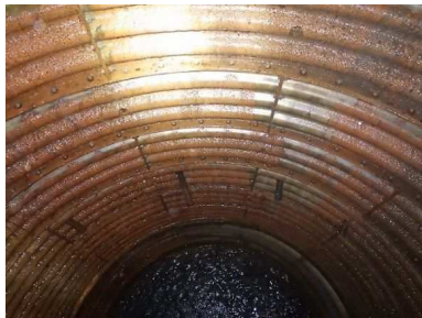
集水井鋼材の腐食
