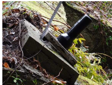
アンカー頭部の浮き
