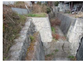
床固工のひび割れ
