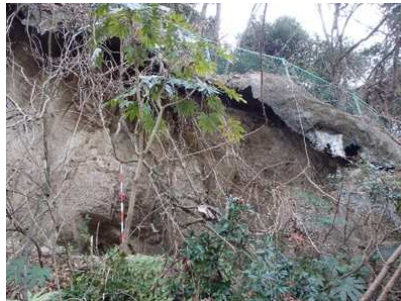
モルタル吹付の剥落
