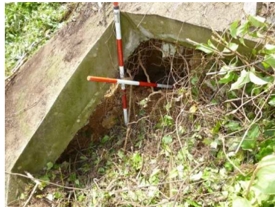
法枠工背面土砂の流出
