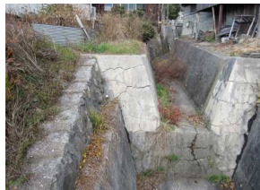
床固工のひび割れ
