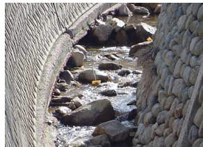
護岸工基礎部の洗堀
