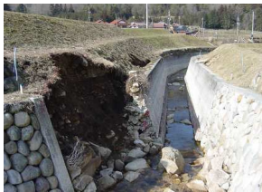
護岸工の損傷
