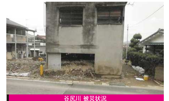
谷尻川 被災状況
