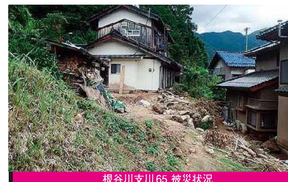
根谷川支川65 被災状況
