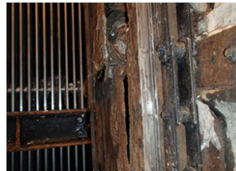
処理場機械 腐食状況
