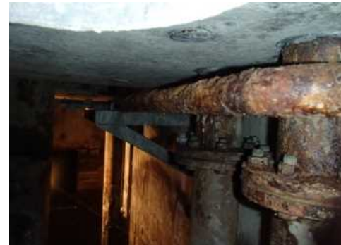
処理場内配管 腐食状況
