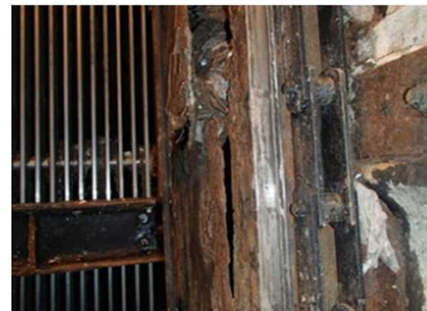
処理場機械 腐食状況
