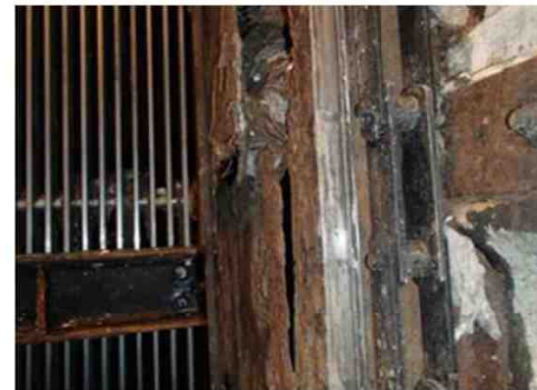
処理場機械 腐食状況
