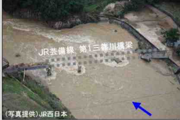
三篠川の鉄道橋落橋状況
