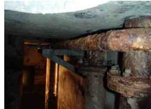
処理場内配管 腐食状況
