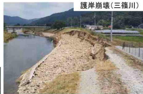
護岸崩壊(三篠川)
