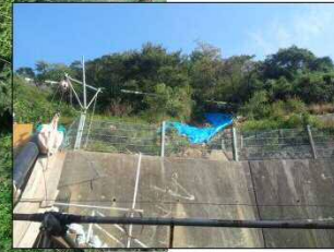
③ 崩壊状況
