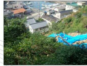
⑧ 崩壊状況
