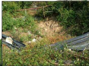
④ 崩壊状況
