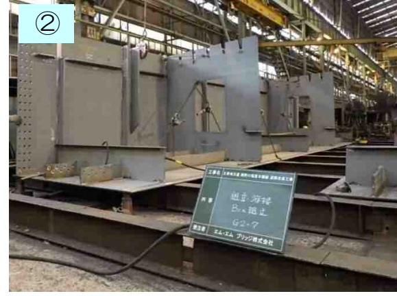
製作された鉄板を橋の工場に持ち込んで切断後、箱の形に組み立てていきます。
