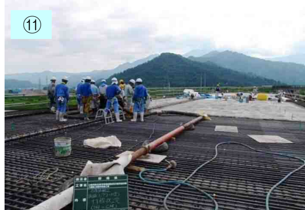
箱けたの上に車や人が直接のる部分となる床をコンクリートにて造ります。
