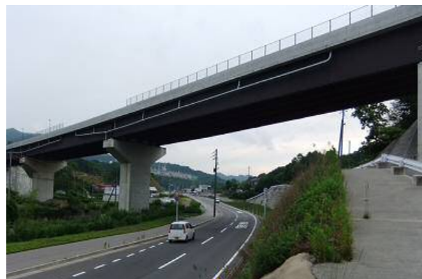
東広島呉自動車道と呉環状線（郷原IC付近） (背後の工場は郷原工業団地)
