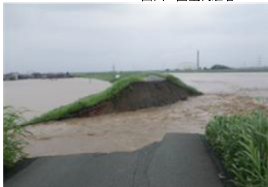
■矢部川の基盤漏水による堤防決壊(H24. 7)
