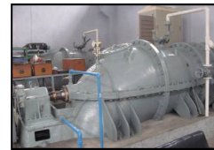
排水機施設(新安川)
