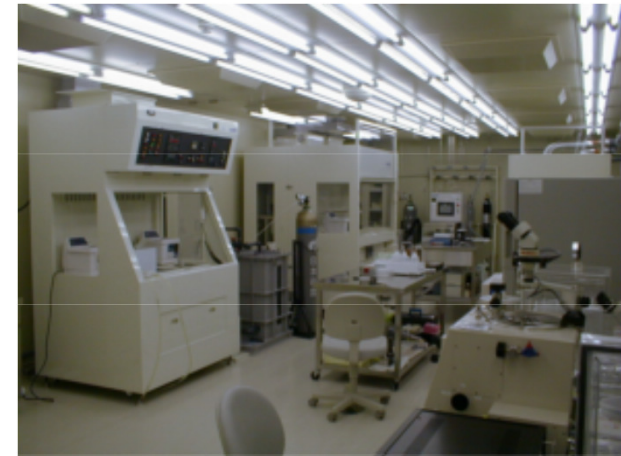
クリーンルーム
