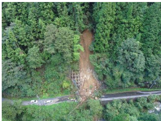
被災後（令和4年9月）
