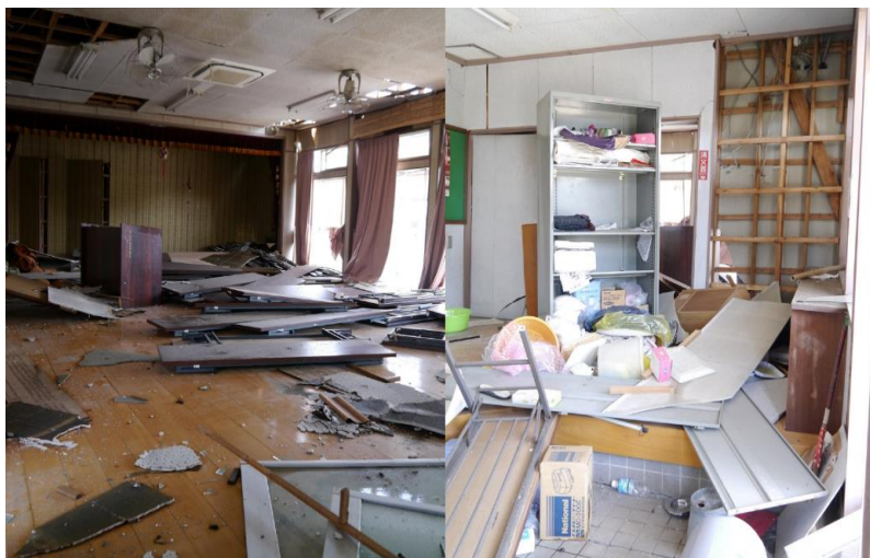
© 株式会社サイエンスラフト / 平成28年（2016年）熊本地震、益城町周辺にて撮影
