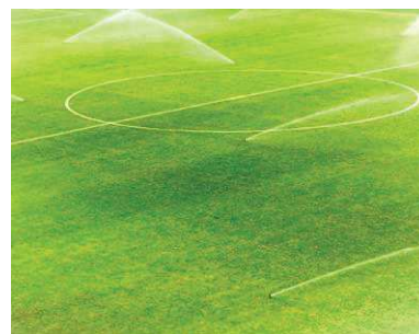
芝の散水設備
