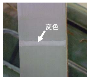
図1 TIG溶接部の変色状況(A6061)
