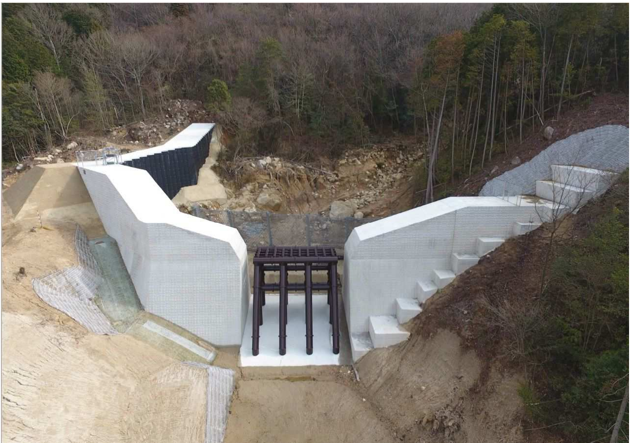
二河川支川 21 災害関連緊急砂防事業（安芸郡熊野町川角五丁目）
