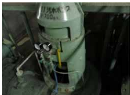
汚水ポンプ外観状況
