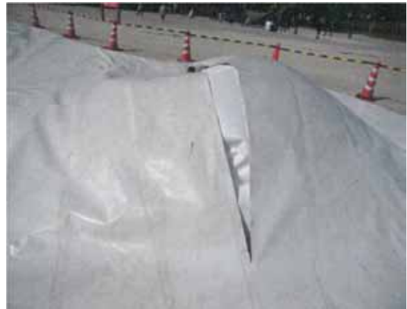
使用禁止措置(近景)
