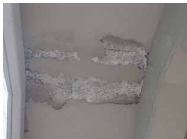
陸上競技場天井化粧剥離
