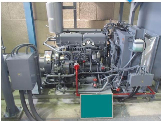
【原動機 修繕後】
