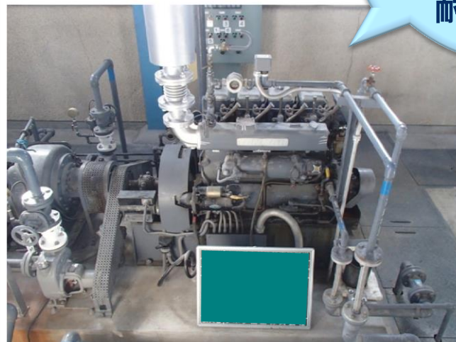
【原動機 修繕前】
