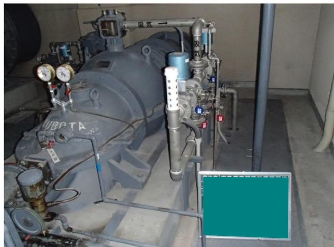
【排水ポンプ 修繕前】
