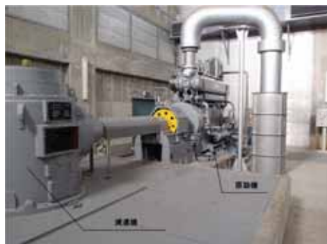
【主原動機・減速機 (岡ノ下排水機場)】
