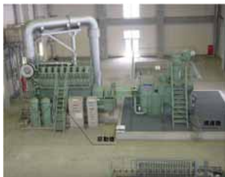
【主原動機・減速機 (手城川排水機場)】
