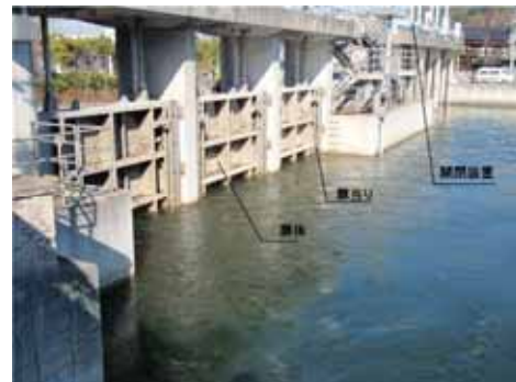
【吐出樋門 (手城川排水機場)】
