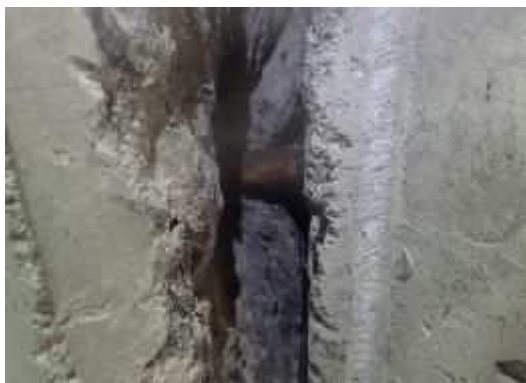
覆工アーチ部のはく落・鉄筋露出
