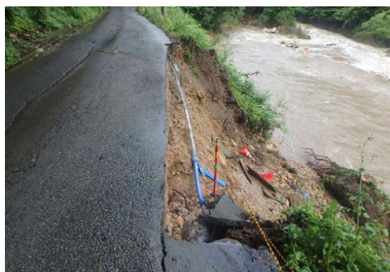
一般県道下門田泉吉田線 三次市君田町（被災状況）
