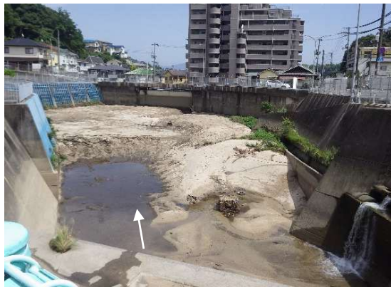
堆積状況（撤去前）
