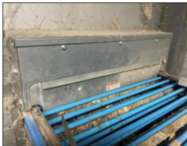
図7 バーコン部へのシャッター設置（C農場）
