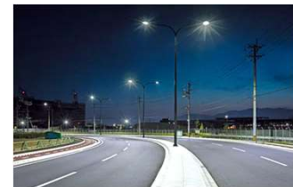
道路照明のLED化
