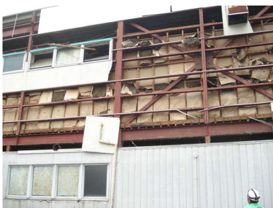
石綿露出状況の調査（目視確認） 写真：熊本県 （出典：環境省「災害時における石綿飛散防止に係る取扱いマニュアル」）
