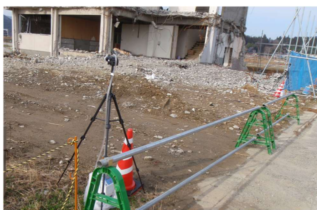
アスベストモニタリング 損壊建築物近傍での測定例 （出典：環境省「災害時における石綿飛散防止に係る取扱いマニュアル」）
