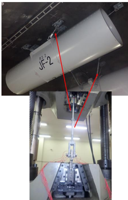
トンネル換気用ジェットファンのターンバックル
