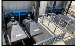
ポンプゲート (2.25m 3 /s × 4基)
