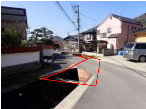
①市道橋部：断面不足，余裕高不足（断面1.9m）
