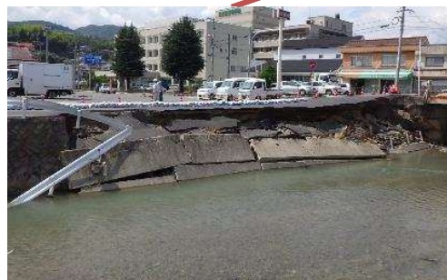
三津大川の護岸崩壊(東広島市)
