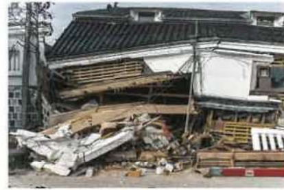
地震による被害例 (能登半島地震)
