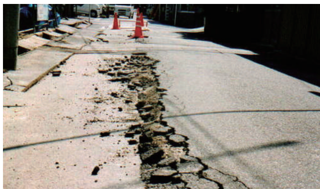
どうろ わ 道路のひび割れ(三原市円一町) しゅつてん み ほうし こうほう へいせい 出典:三原市「広報みはら」平成29年3月号
