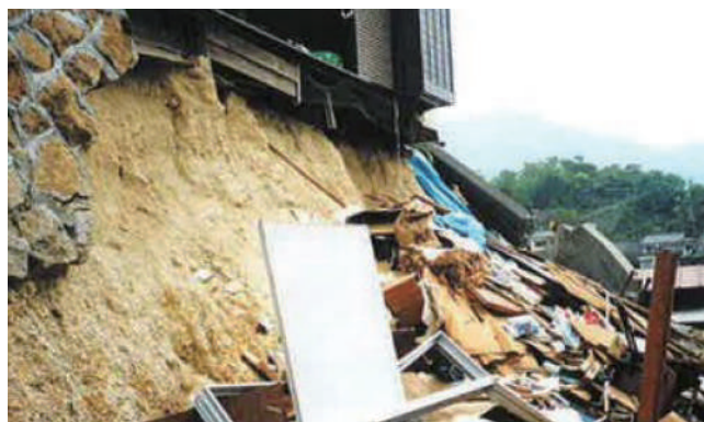
じゅうたく ひが 住宅の被害(呉市東愛宕町) しゅつてん げい よ じ しん かか みんかんたくち ようへきふつきゅうじぎょう きろく 出典:芸予地震に係る民間宅地擁壁復旧事業の記録
