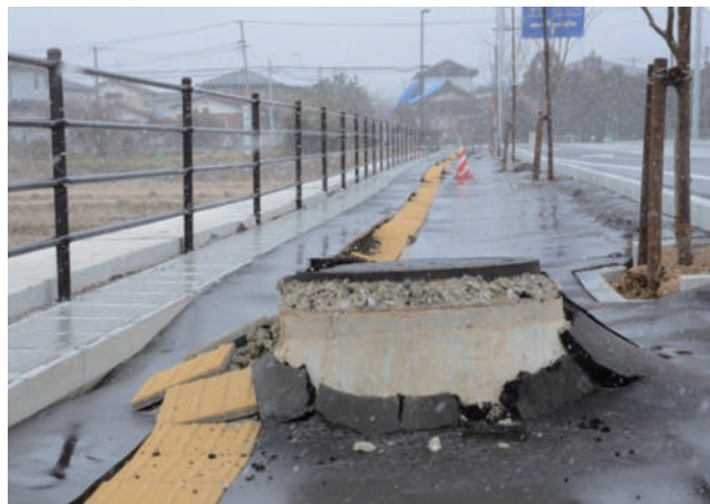
液状化現象によりうき出した下水道マンホール
