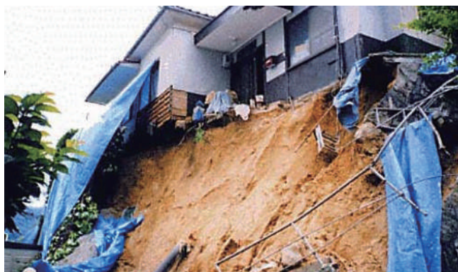
じゅうたく ひが 住宅の被害(呉市西畑町) しゅつてん げい よ じ しん かか みんかんたくち ようへきふつきゅうじぎょう きろく 出典:芸予地震に係る民間宅地擁壁復旧事業の記録
