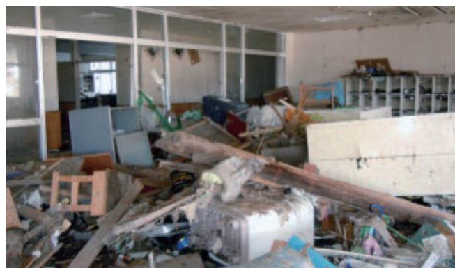
津波が引いた後の小学校内部の様子
