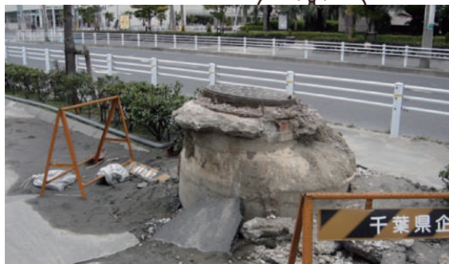
地面が液状化してマンホールがうき出した様子
