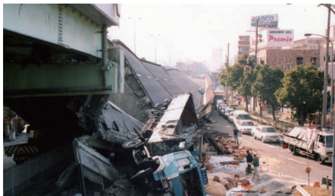
橋の上の道路がたおれた様子
