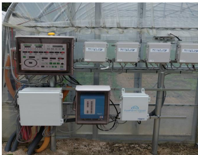
環境制御装置
