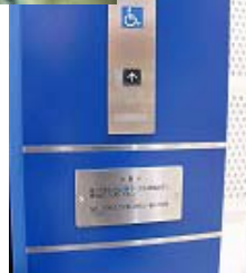
エレベーター設備
