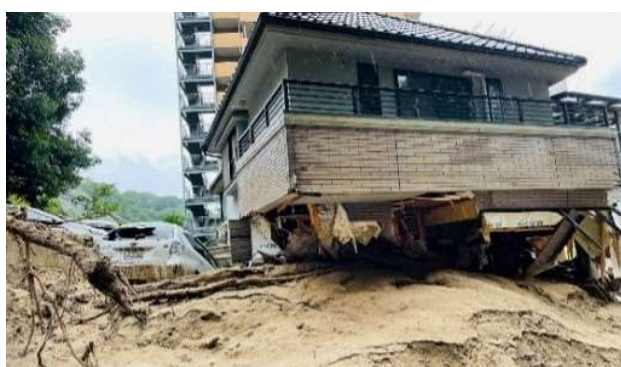
土砂災害による被害(広島市西区:令和3年8月豪雨)
