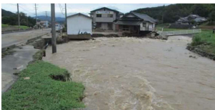
河川の護岸崩壊(冠川:令和3年8月豪雨)
