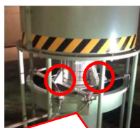
排水ポンプ分解整備前の振動データのさらなる蓄積 常時状態監視に向けた端末等の調達
